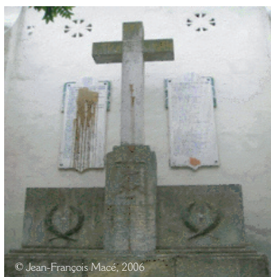
● Fig.3 : monument de l'église de Ciempozuelos (Madrid), avant sa restauration
